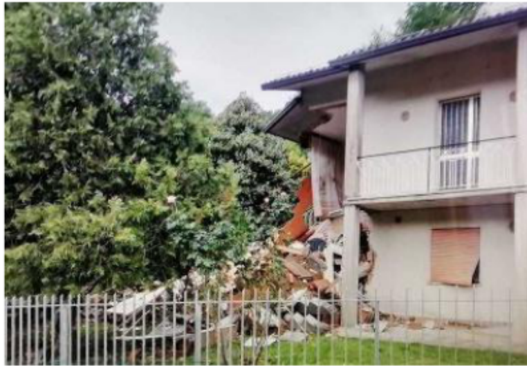
Una casa disabitata sbriciolata da una frana. A destra la frana sulla provinciale
